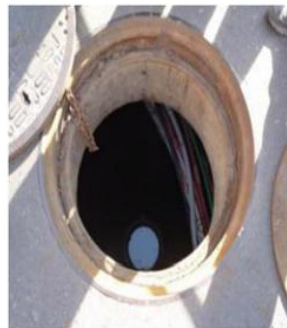
(d) 电力电缆井
